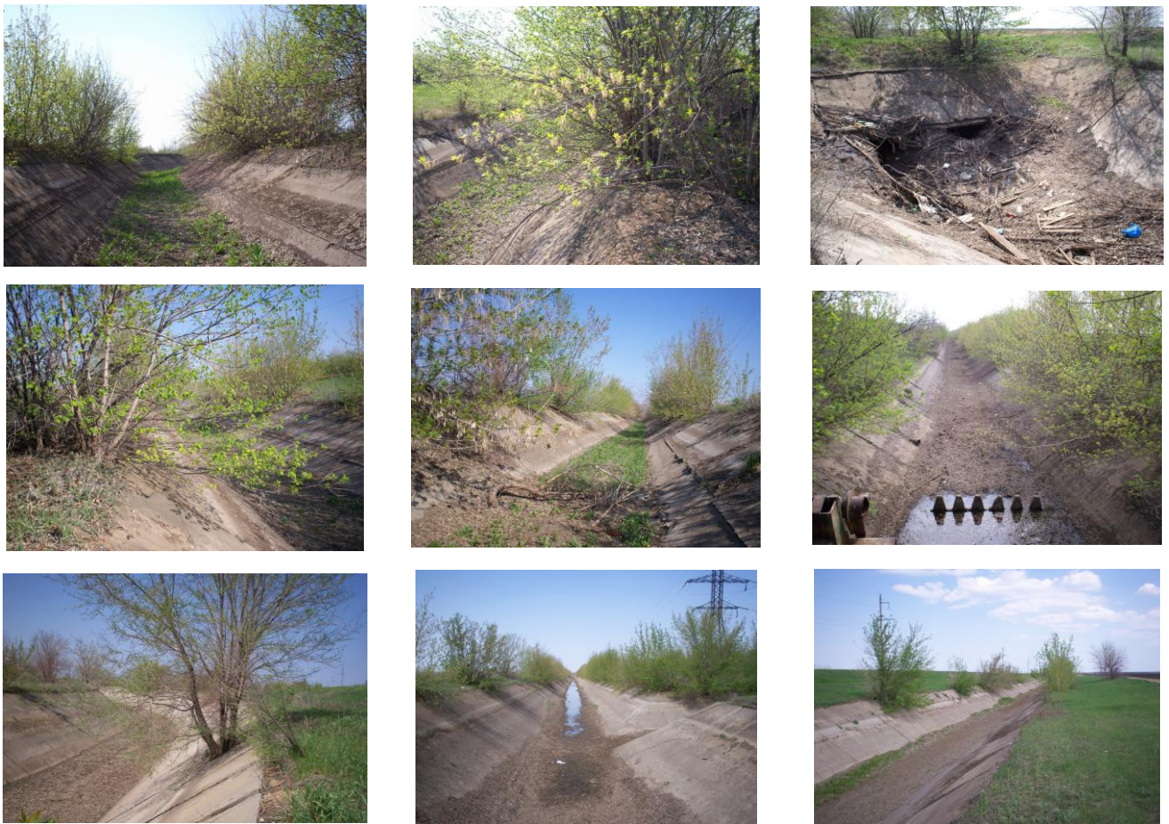
Рисунок 4.1 – Состояние оросительных систем, требующих проведения эксплуатационно-ремонтных работ
