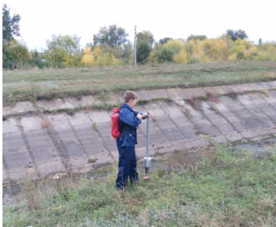
7. Угнетение пней на откосах канала
